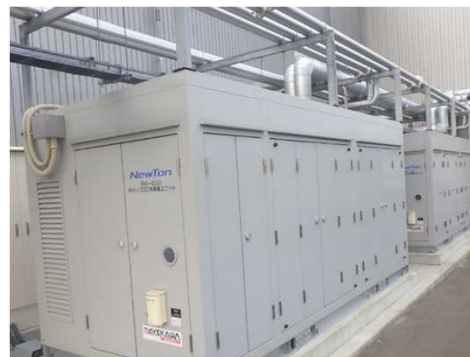
冷凍機ユニット
