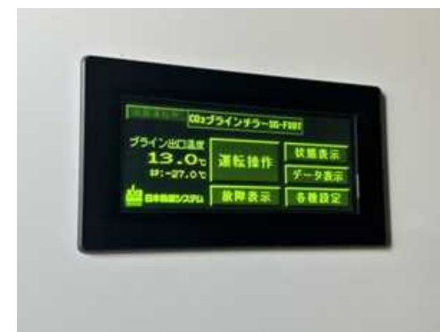
冷凍機パネル
