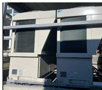
高効率ヒートポンプ熱源機設備
