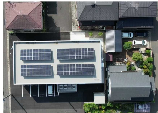
太陽光発電設備
