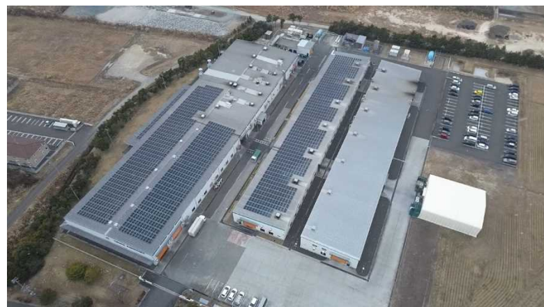
太陽光発電設備全景
