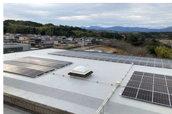
太陽光発電設備
