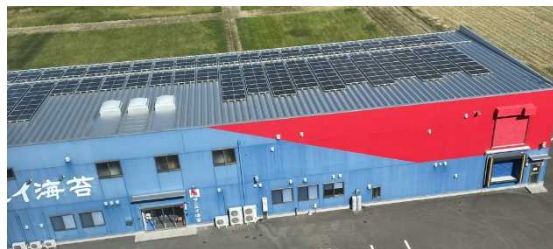
太陽光発電設備①
