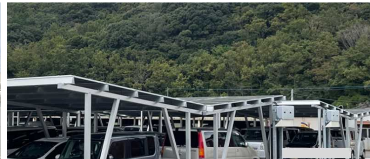
太陽光発電設備（市役所）
