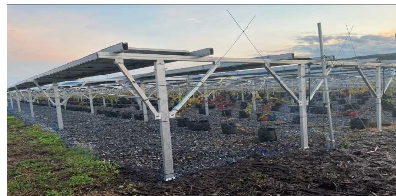
太陽光発電設備
