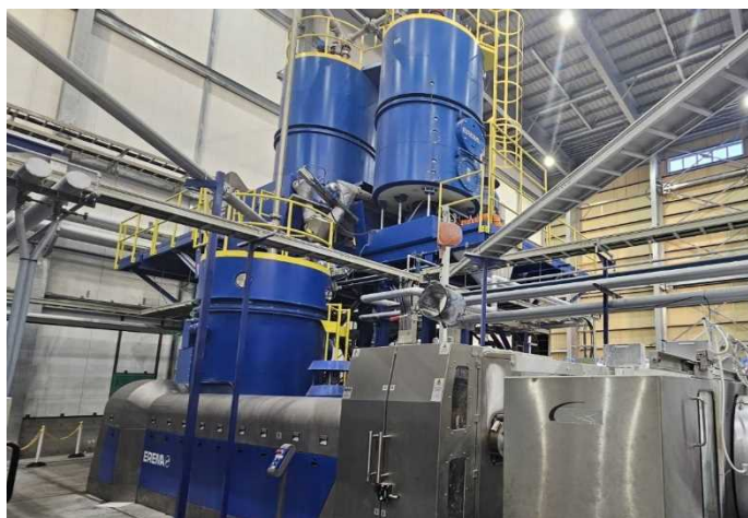
①メカニカルリサイクル設備 [処理能力 1,800kg/h]
