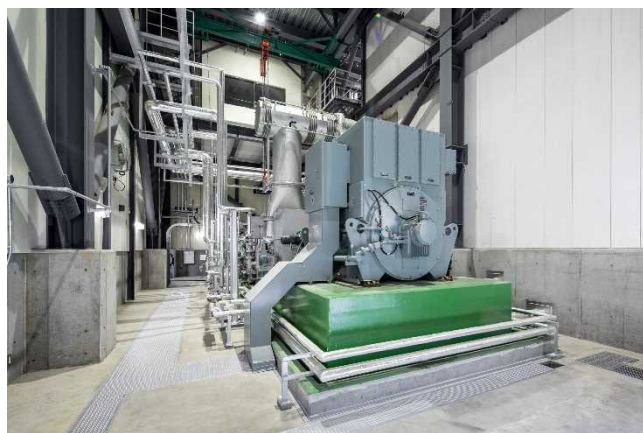
タービン発電機
