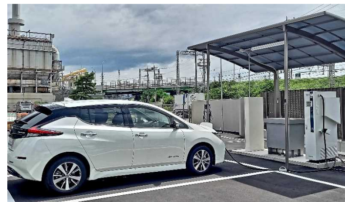
PHV/EV車両充電スタンド
