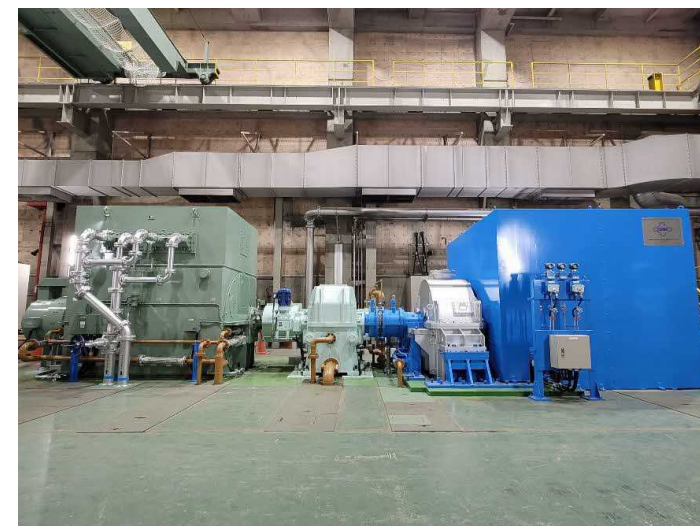
蒸気タービン発電機
