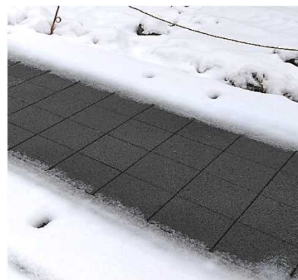
設備の敷設箇所
