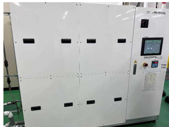
水電解システム電源、水素発生制御抑制装置、水電解スタック
