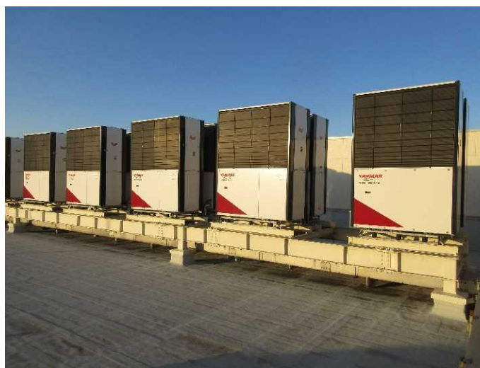
高効率空調機器
