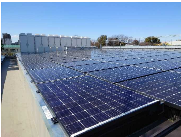
太陽光発電設備
