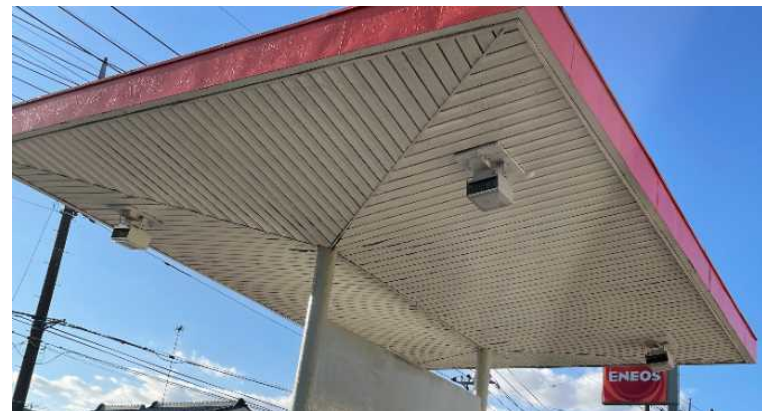
LED照明設備
