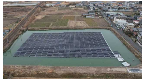
太陽光パネル (フオート式架台に設置)
