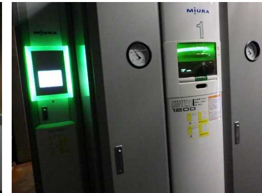
低圧ボイラー
