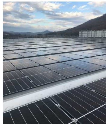
太陽光パネル
