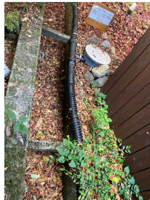
温泉供給配管
