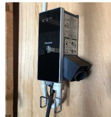
EV車用充電器
