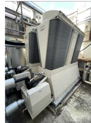
高温水ヒートポンプ
