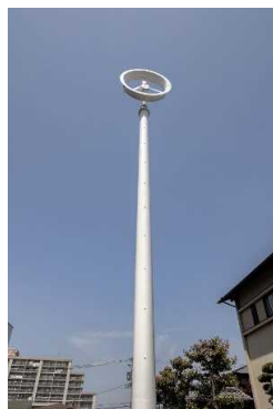
風力発電設備※
