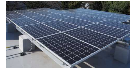
太陽光パネル
