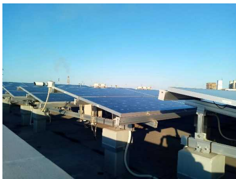
太陽光発電設備
