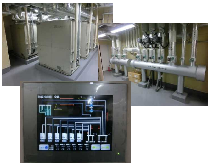
地中熱ヒートポンプ空調
