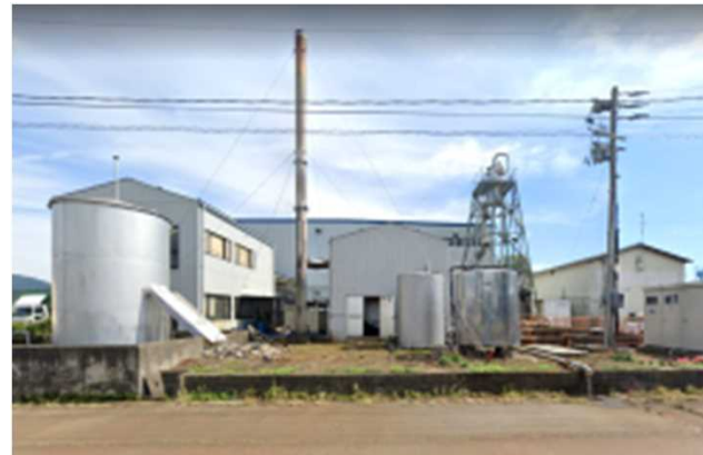
導入前 重油タンク
