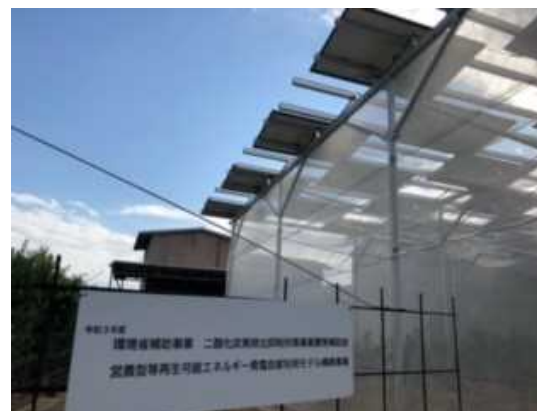
太陽光パネル
