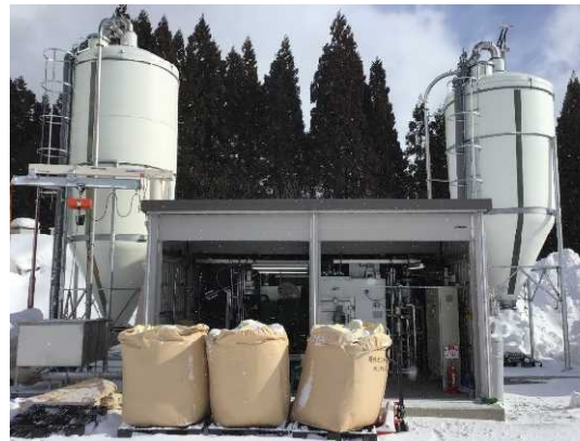
バイオマスボイラー
