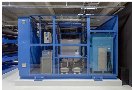
水素製造設備
