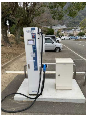
EV用急速充電器の設置状況
