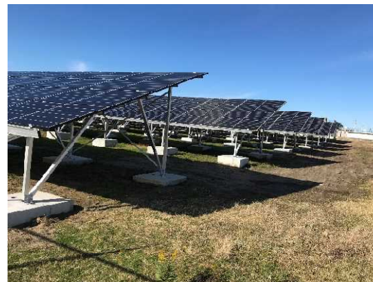
太陽光パネル
