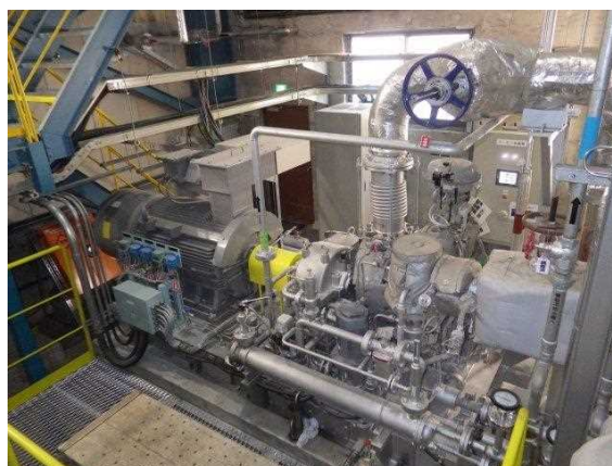
蒸気タービン発電機
