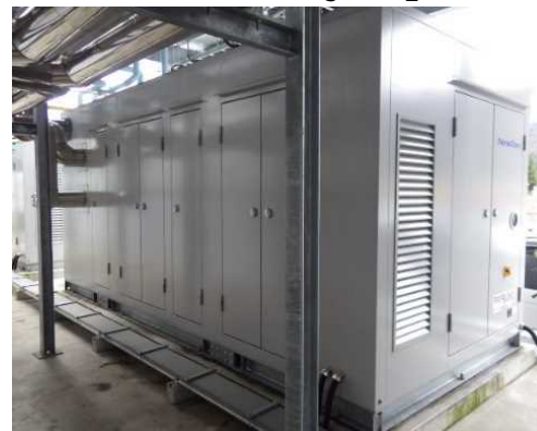
冷凍パスタライン：NH 3 /CO 2 冷凍機
