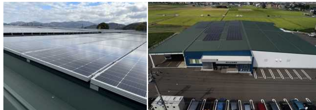
株式会社土田鶏卵下中GPセンター屋根上の導入設備（太陽光パネル）
