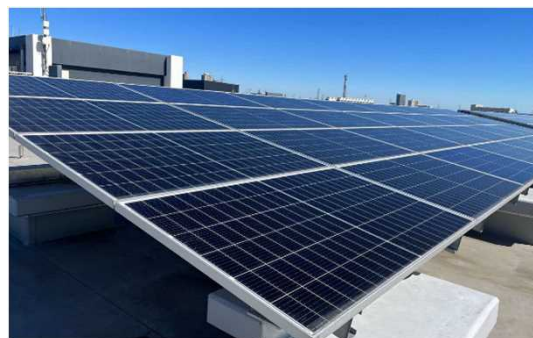
太陽光発電設備
