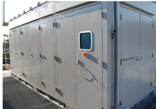
冷凍機ユニット（外観）
