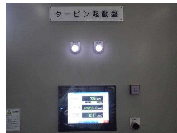
タービン起動盤
