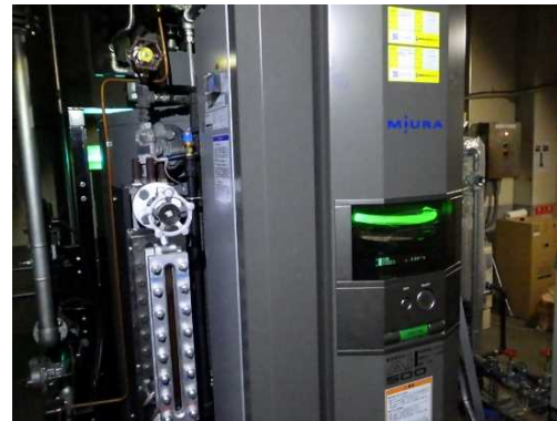
高圧ボイラー
