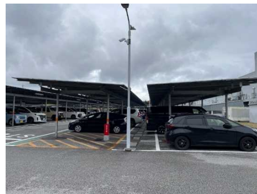
ソーラーカーポート （太陽光発電設備、パワーコンディショナー）
