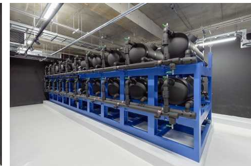
水素貯蔵設備
