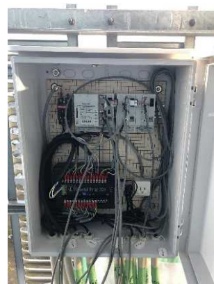
空調最適制御システム（制御盤）
