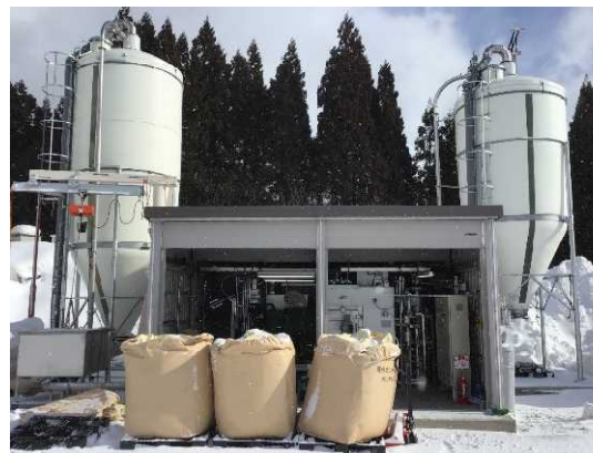
バイオマスボイラー
