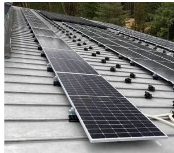
太陽光発電設備
