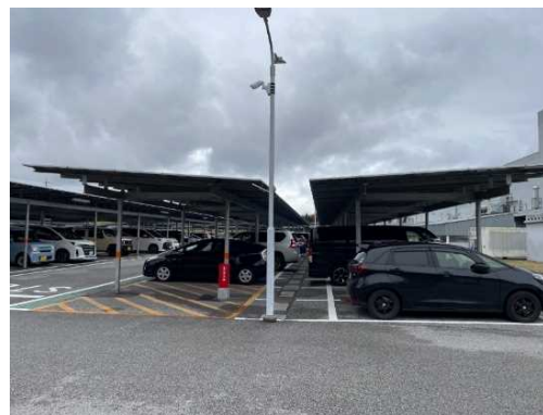
ソーラーカーポート （太陽光発電設備、パワーコンディショナー）
