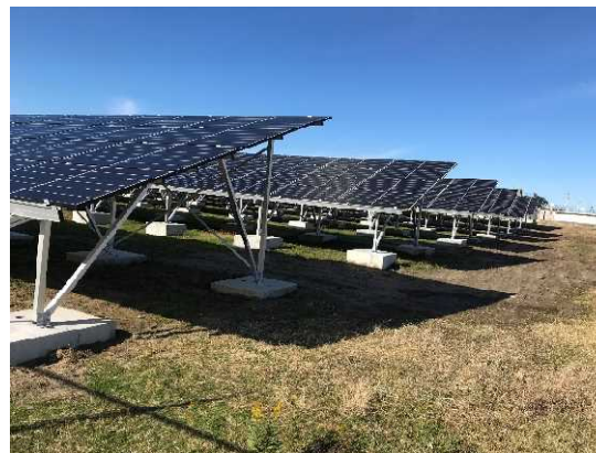
太陽光パネル
