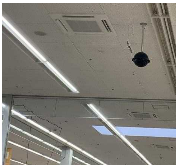
高効率空調 室内機
