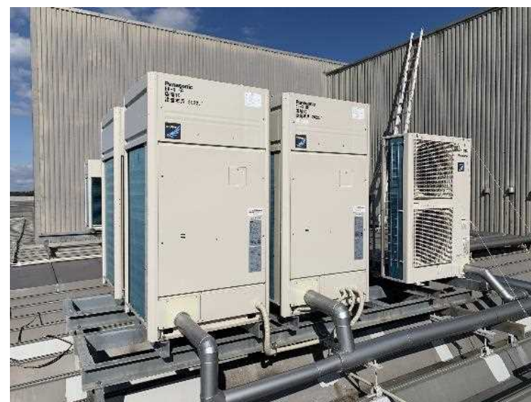
高効率空調 室外機
