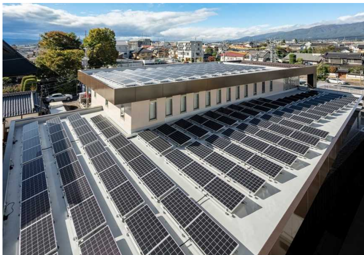
太陽光発電設備
