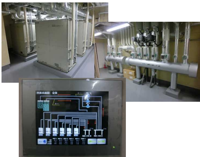
地中熱ヒートポンプ空調
