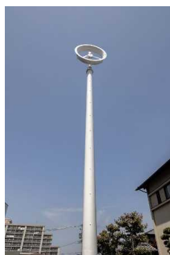
風力発電設備※
