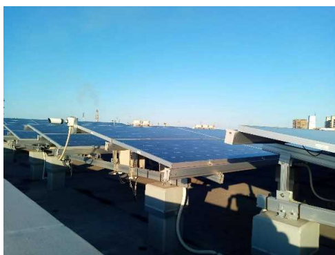
太陽光発電設備
