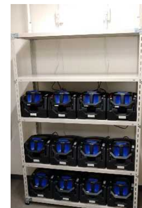
バッテリーステーション
