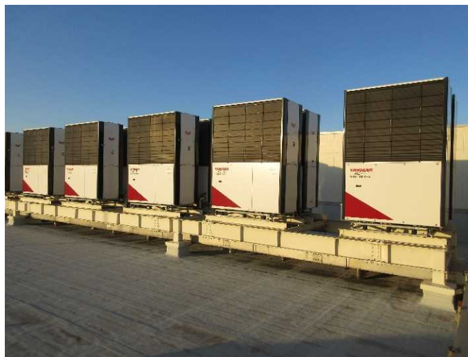
高効率空調機器
