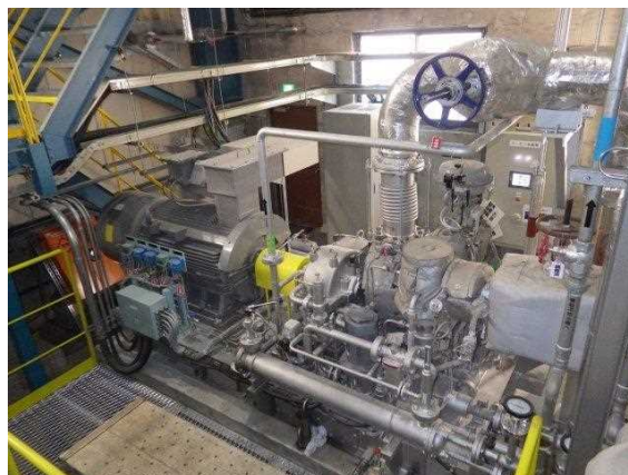
蒸気タービン発電機
