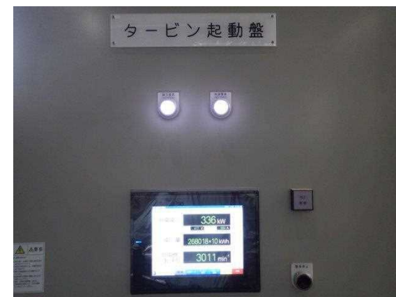
タービン起動盤
