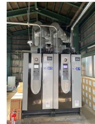
ガス焚き貫流ボイラ
