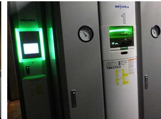
低圧ボイラー
