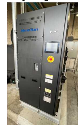
NH 3 /CO 2 冷媒冷凍機（外観）
