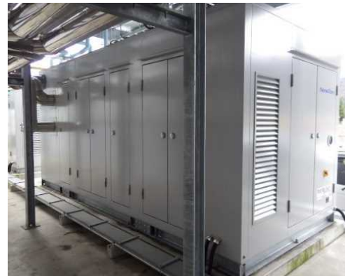
冷凍パスタライン：NH 3 /CO 2 冷凍機
