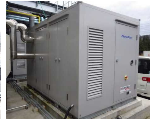
冷凍ソテー麺ライン：NH 3 /CO 2 冷凍機
