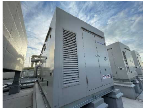
冷凍機ユニット（外観）
