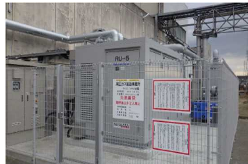
アンモニア冷媒冷凍冷蔵機
