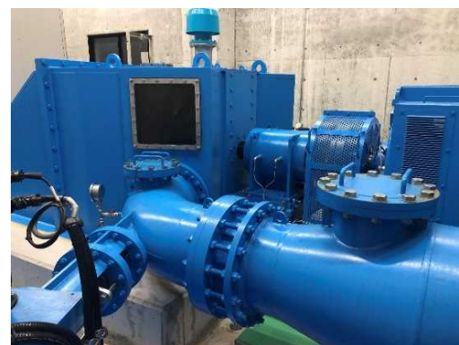
水車内蔵設備
