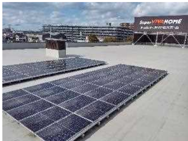
太陽光発電設備
