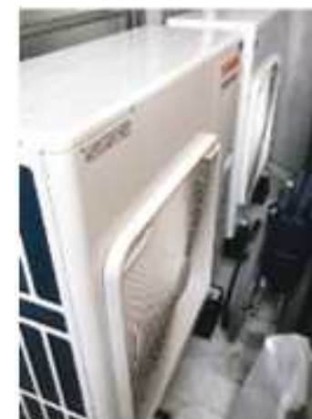
エアコン室外機
