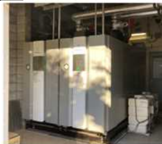
ガス焼き高効率ボイラ (設備本体)
