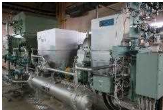
蒸気タービン・発電機
