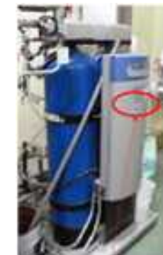
ドレン回収設備
