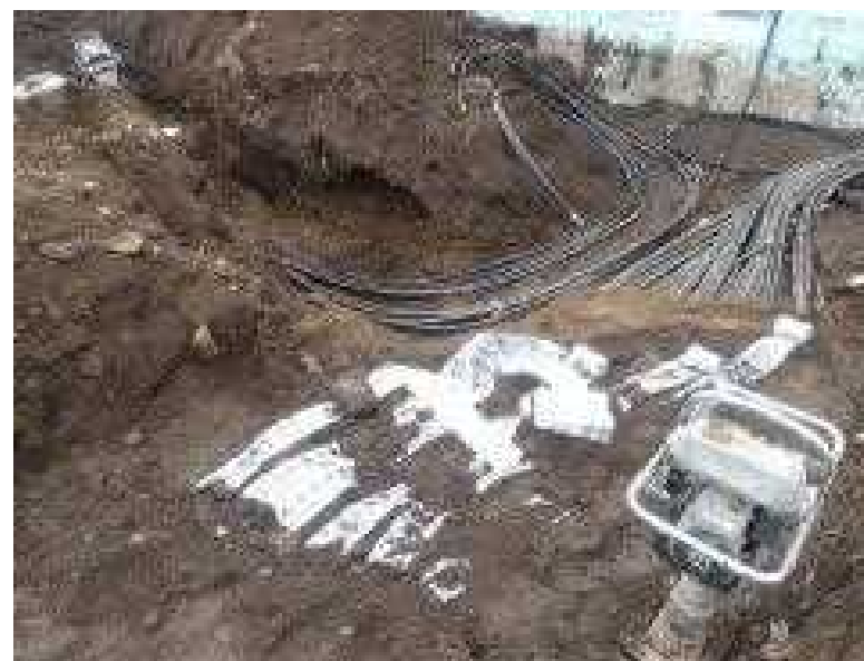
導入設備（地中熱交換器）
