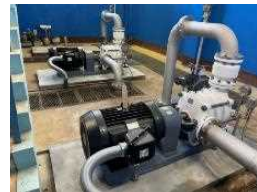
高効率ポンプ (野畑中継ポンプ場)
