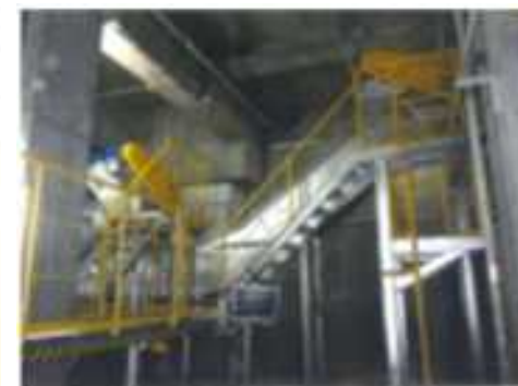
焼却残渣コンベア
