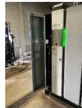
蒸気ボイラ (都市ガス) (設備内部)
