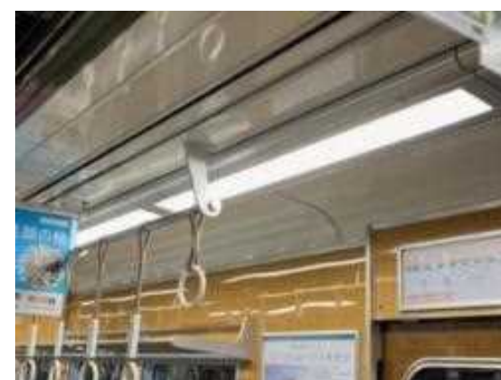
LED照明装置
