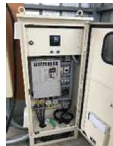
インバータ制御盤 (設備内部)
