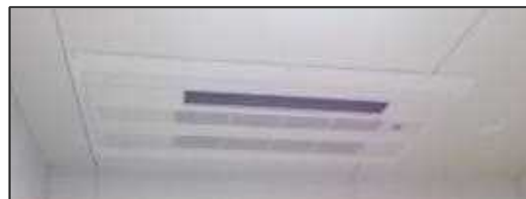
高効率空調機 (室内機)
