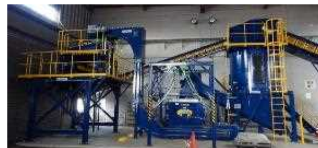
上 : 破碎設備 下 : 成型設備
