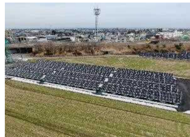
導入設備（太陽光パネル）
