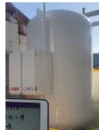
蒸気ボイラ用燃料 (LPGタンク)
