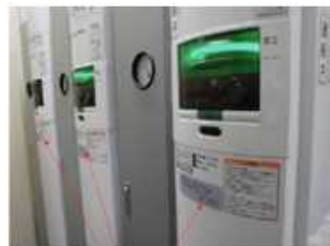
蒸気ボイラ設備
