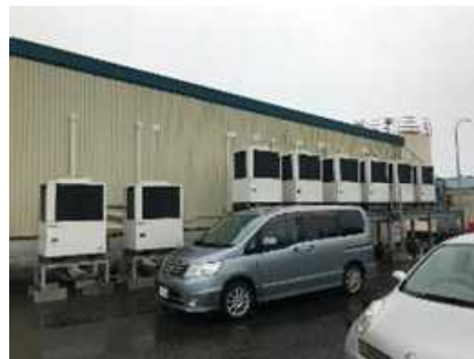
冷凍機ユニット
