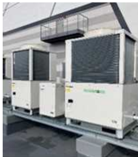
冷凍機ユニット
