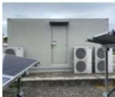
PCS電気室（奥）/ 太陽光発電設備（手前・既設）
