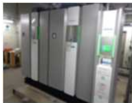
蒸気ボイラ (LNG)
