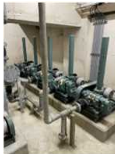
付帯設備 (浄化槽システム)
