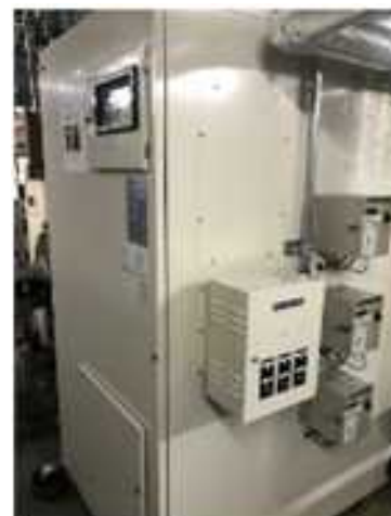
温水ボイラー
