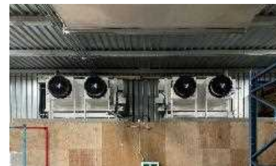
ガスクーラー (冷凍庫内部)
