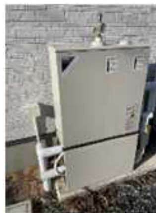
地中熱ヒートポンプ
