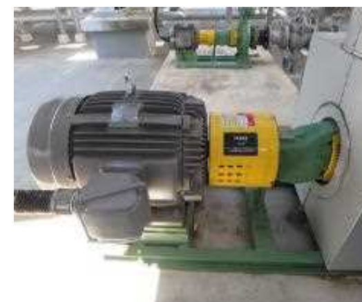
過冷却水ポンプ
