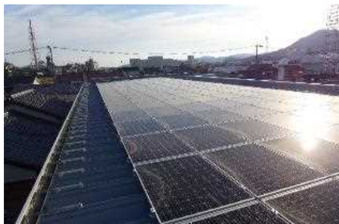
太陽光発電設備
