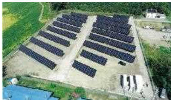
太陽光発電設備
