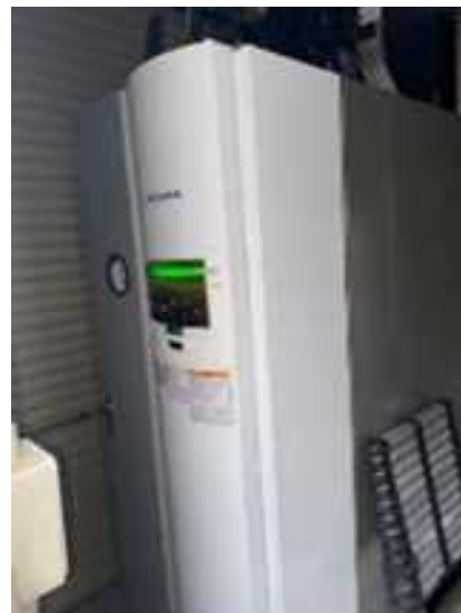
ガス焚ボイラ
