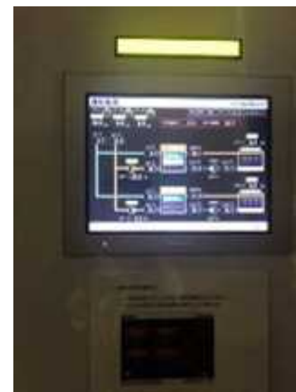
総合省エネ制御装置 (制御盤)
