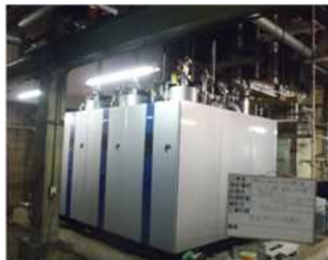
蒸気ボイラ (LPG) (設備本体)
