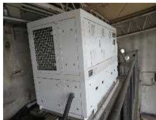
冷凍機ユニット (冷凍庫外部)
