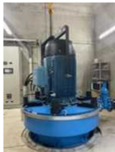
水車発電機部
