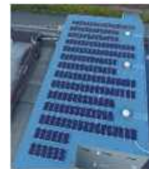
太陽光発電設備
