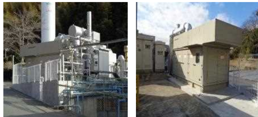
コージェネレーション設備
