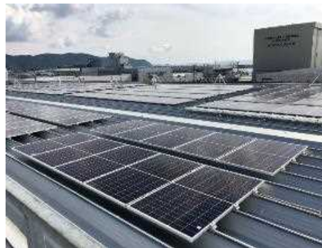
太陽光発電設備
