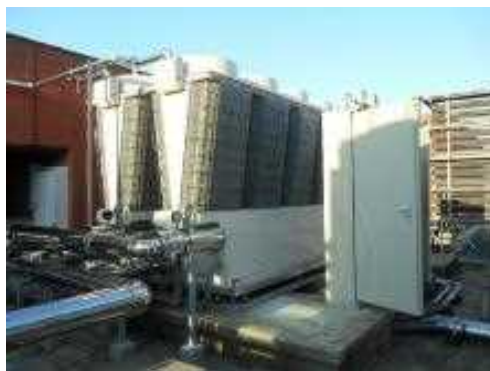
空冷ヒートポンプチャラー
