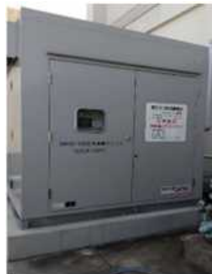
冷凍機ユニット
