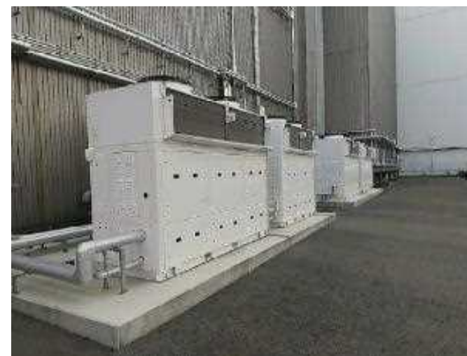
冷凍機ユニット
