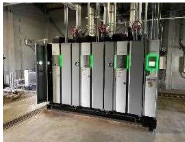
蒸気ボイラ (都市ガス) (設備本体)
