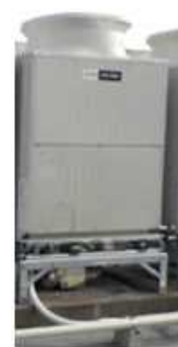
高効率空調機 (室外機)
