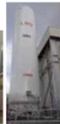
LNGサテライト
