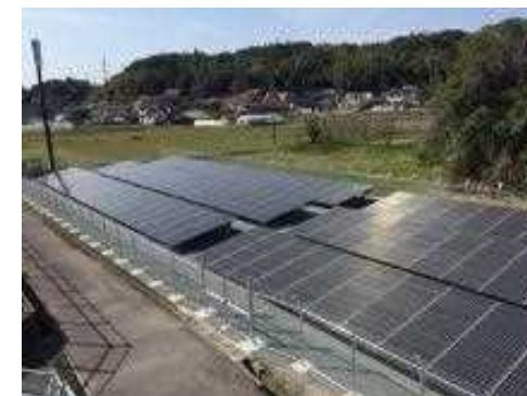
太陽光発電設備
