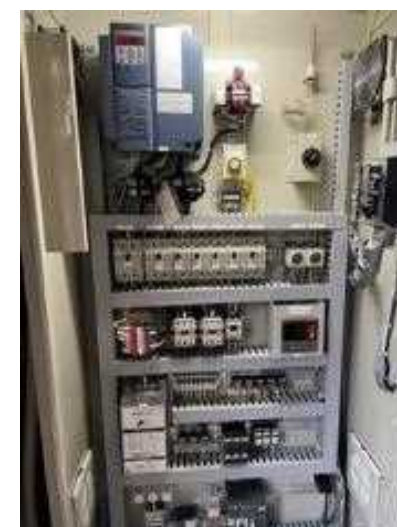
インバータ制御装置 (設備内部)
