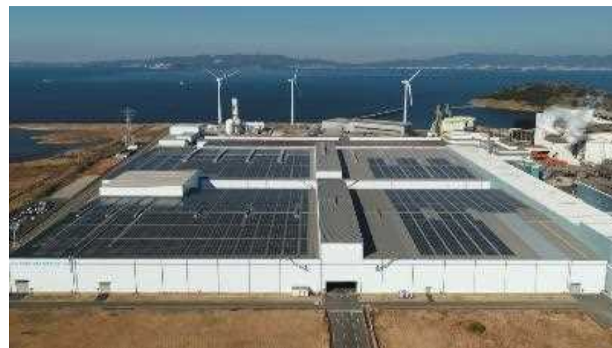
田原工場 製品倉庫棟屋根上の導入設備 (太陽光パネル)
