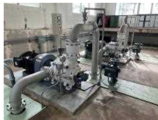
高効率ポンプ (先川浄水場)
