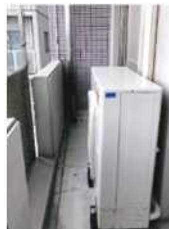
エアコン室外機
