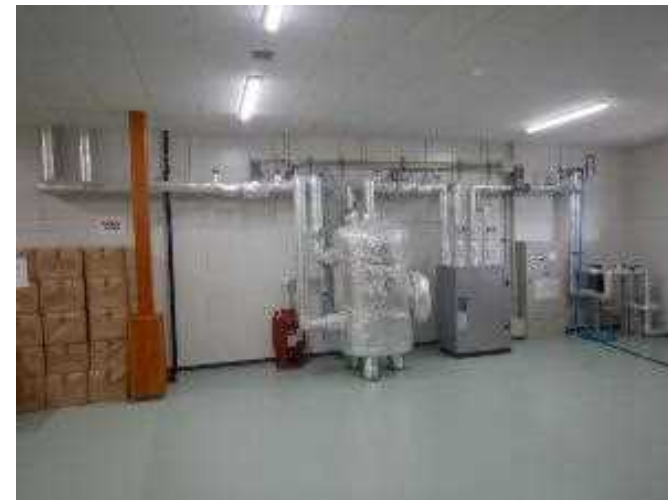
導入設備（情報施設）
