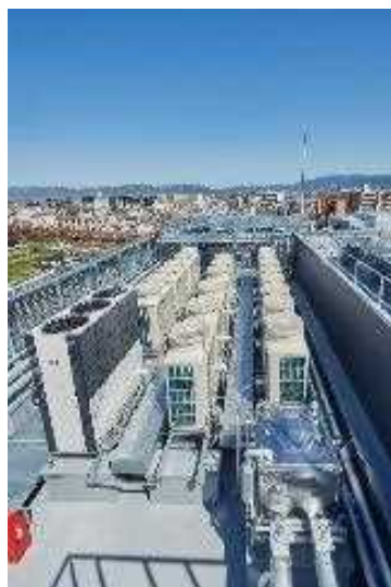
室外機（GHP、EHP）、太陽光発電
