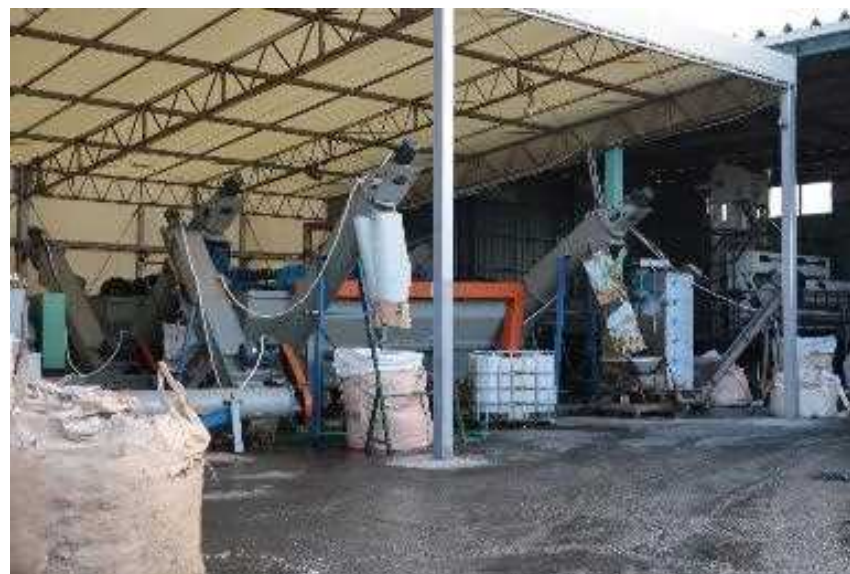
導入設備全景
