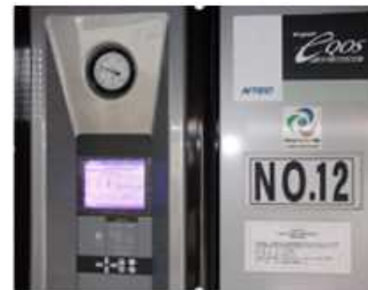
ガス焚貫流ボイラ (制御盤)
