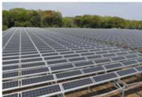
太陽光発電設備
