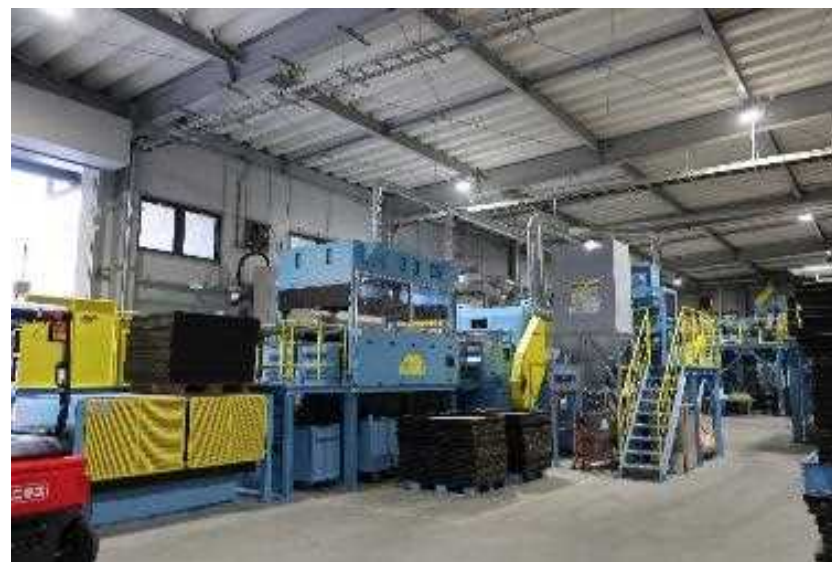
太陽光パネル破碎選別設備
