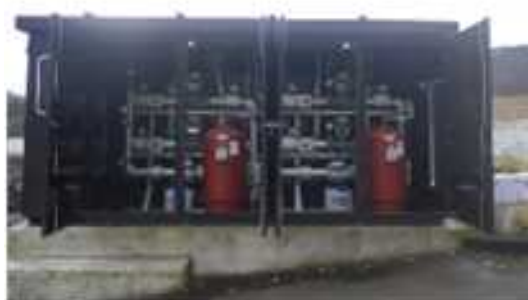
導入設備全体
