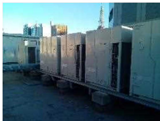
高効率空調 室外機
