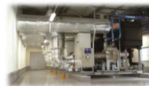
<中央方式冷凍冷蔵機器>
