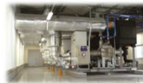
<中央方式冷凍冷蔵機器>
