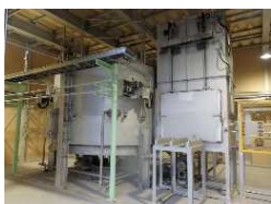
<Li-ion電池リサイクル設備>
