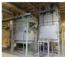
Li-ion電池リサイクル設備
