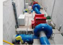
小水力発電(インドネシア) トーヨーエネルギーファーム
