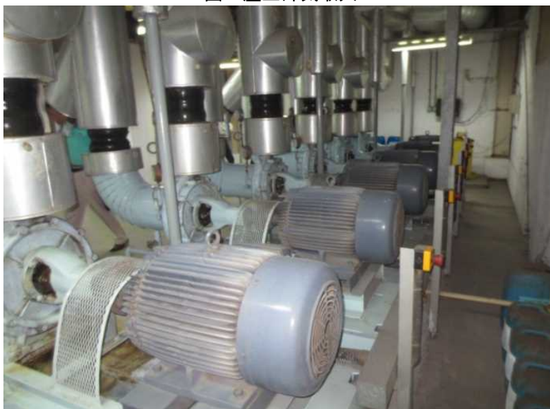
図 屋上階一次冷水ポンプ
