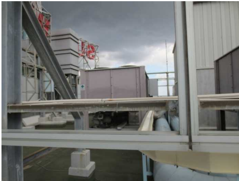
図 屋上冷凍機
