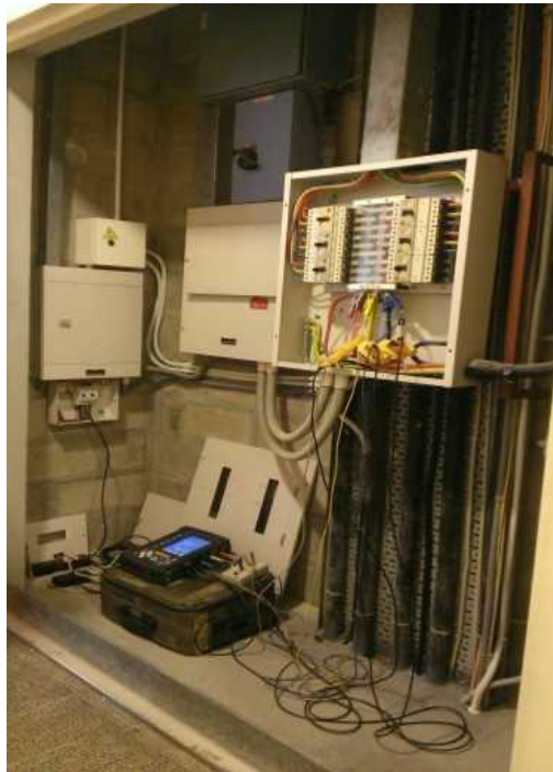
図 テナント階配电箱の電力利用量測定
