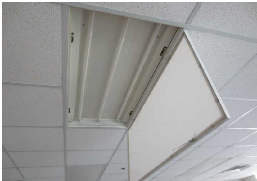
図 テナント内照明器具（蛍光灯）
