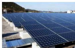
北九州市・太陽光発電所
