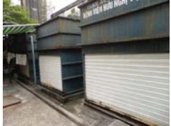
稼働していない処理施設(Viet-Czech病院)
