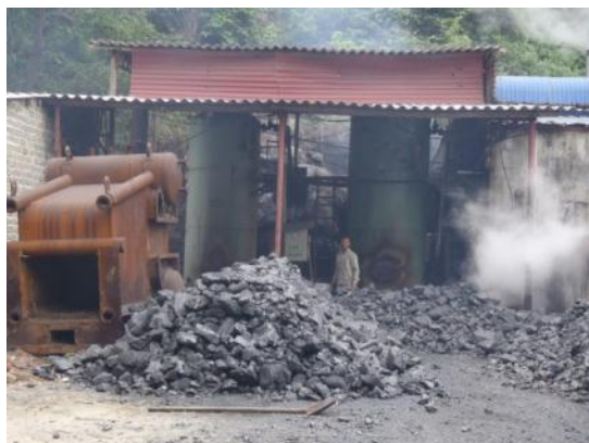
写真 2.1.(19) 魚粉工場の石炭ボイラー
