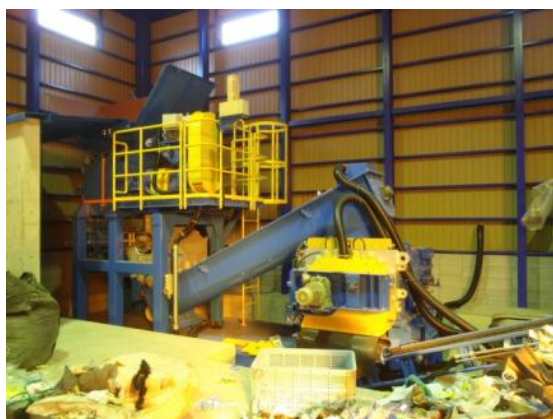
写真 3.1.(5) 固形燃料製造設備（例）
