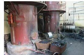
病院の石炭焚きボイラー
