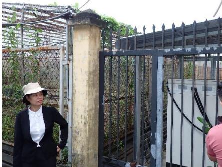
実証用に導入された蓄電池
