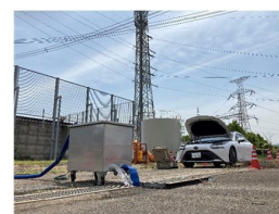
災害時を想定した作業用電源としての FCV活用実験
