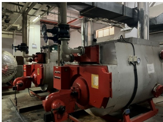
給湯用ボイラ
