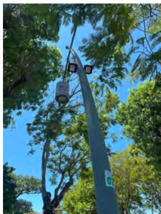
王宮正面エリアのLED照明
