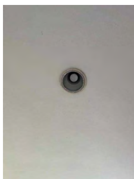
廊下照明の例（豆電球）
