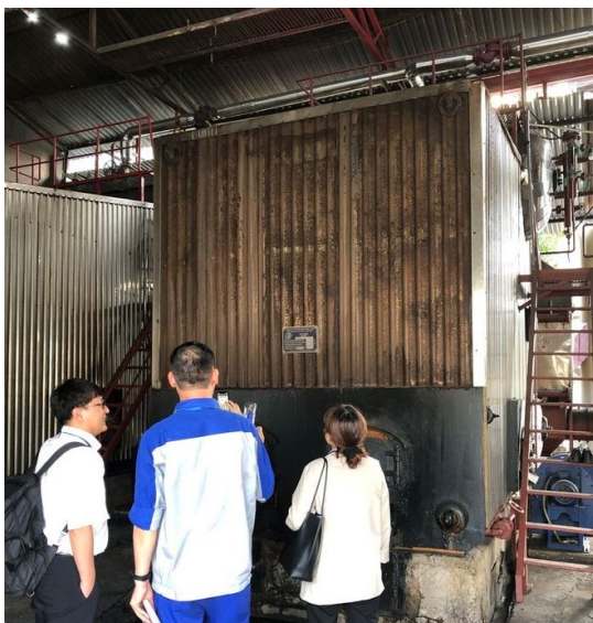
図8 使用中の石炭炊きボイラー
