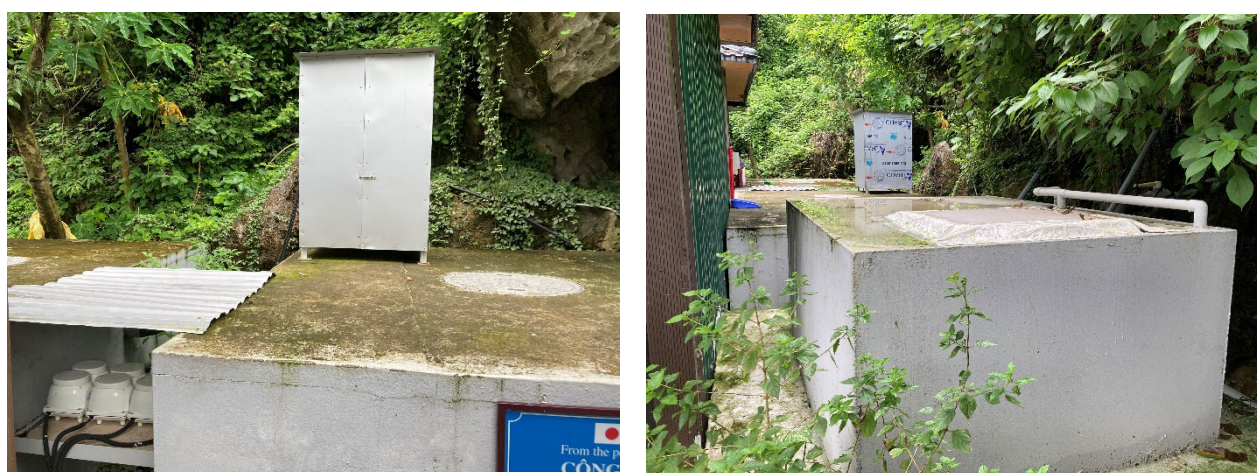
図 10 Dau Go 島に導入された浄化槽（観光客向けの 2 基）
