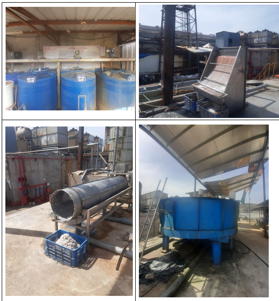
図 30 Viet Tuong 社の排水処理関係設備
