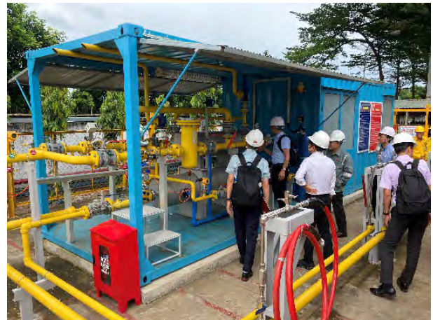
図 2-2 CNG 減圧装置
