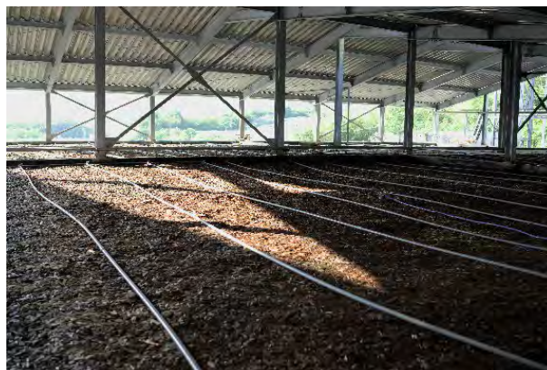
図 2-12 脱臭用バイオフィルター
