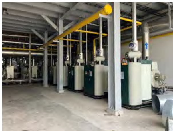
図 2-3 同社が導入した CNG ボイラー
