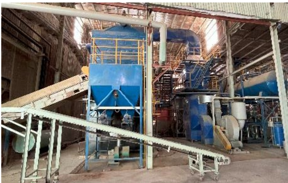
図 2-4 蒸気供給用 40t ボイラ
