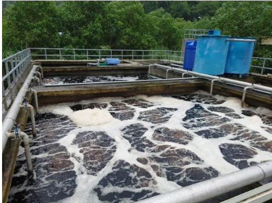
浸出水処理設備（曝気槽）
