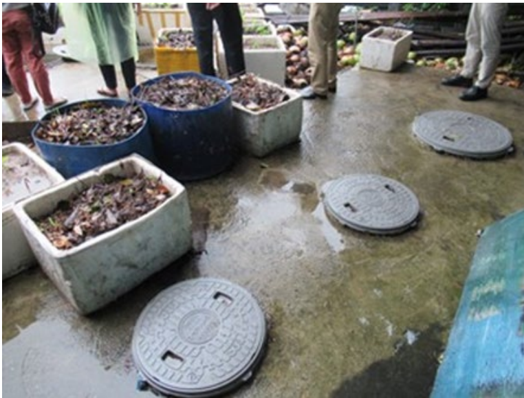
浄化槽上部の蓋
