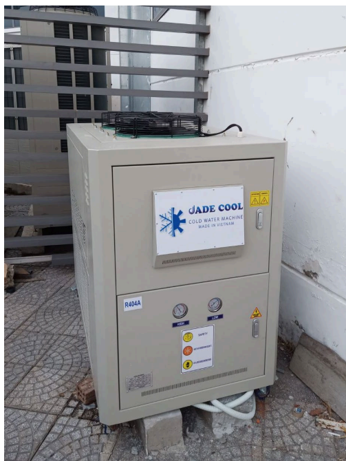
外に設置された室外機
