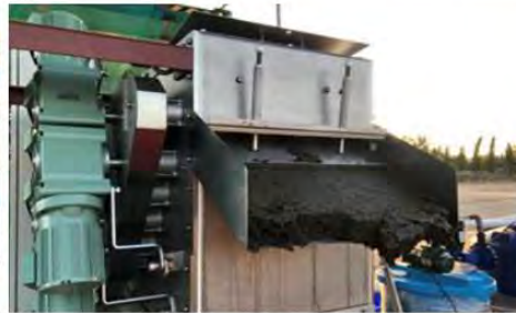
<EGSB前処理工程での脱水汚泥>
