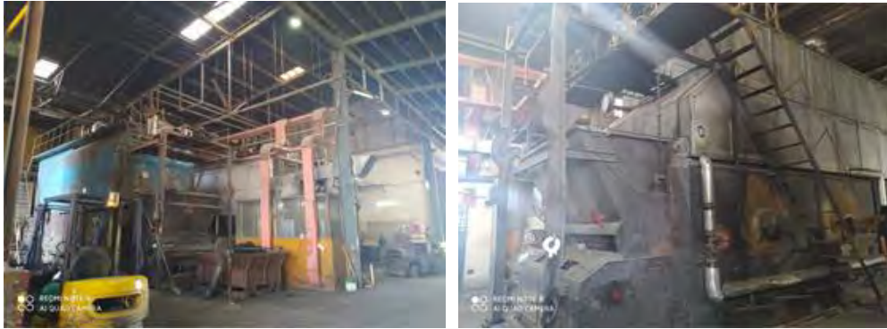
図 39 石炭ボイラの外観（左）及び燃料受入れホッパー（右）
