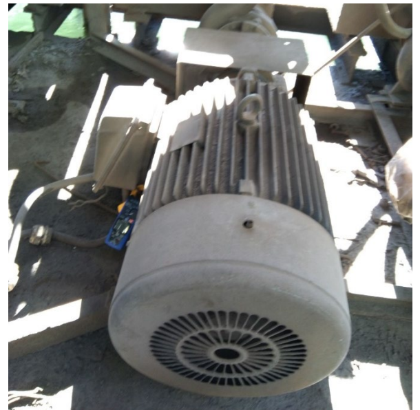
ポンプ電力測定
