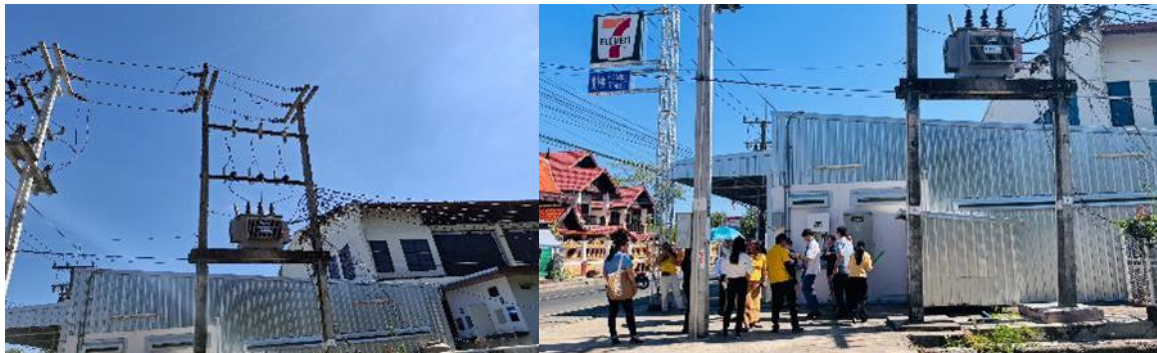
市役所への電力引き込み点と柱上変圧器
