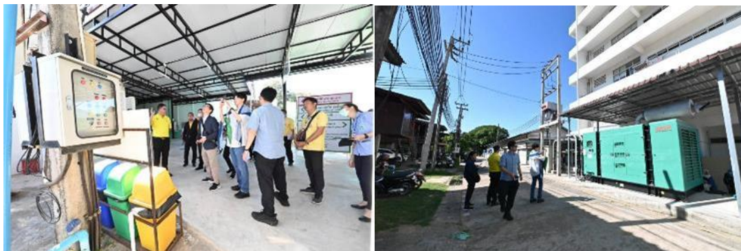
ピブン市立病院内の電力引き込み点と自家発電機
