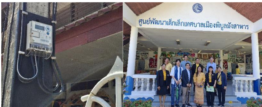
ピブン市立保育園の電力メーターと外観
