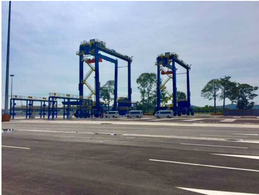
写真 4 内航船ターミナル (Coastal-A) に設置された RTG
