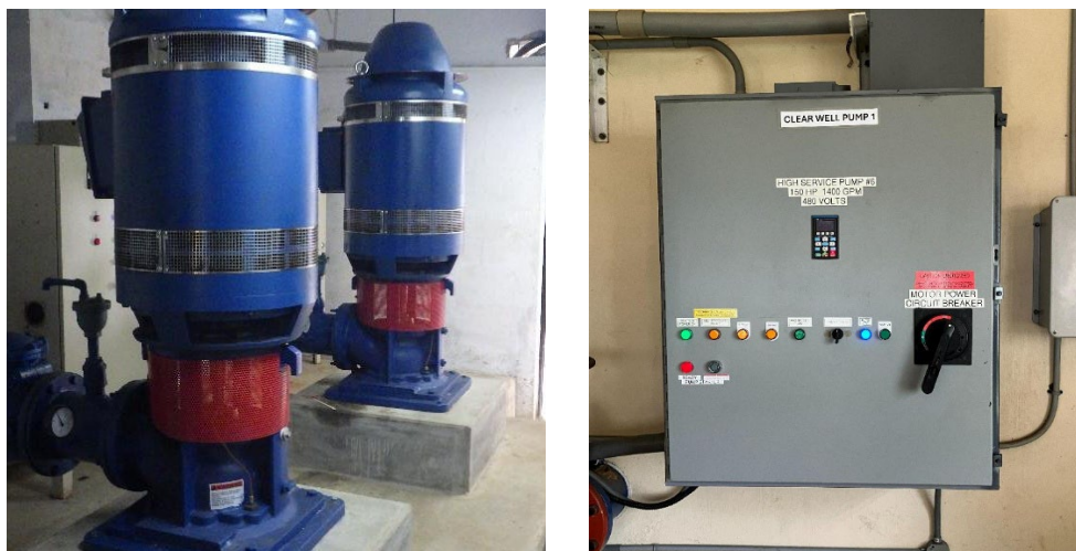
図 2.1-3 送水ポンプ（4台設置）
