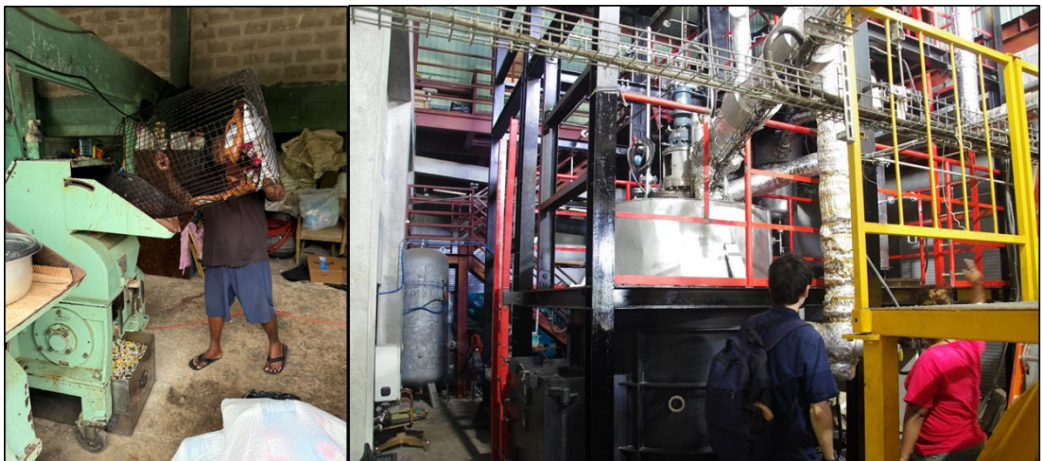
図 2.4-15 プラスチックの破碎および油化設備
