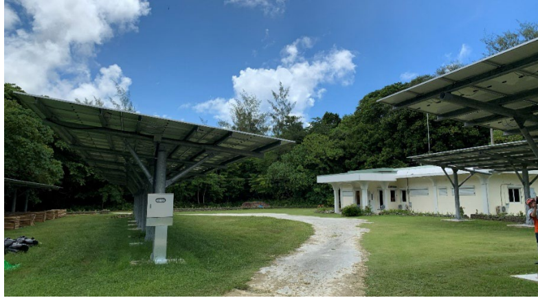
图 2.2-1 No.1 太陽光発電設備
