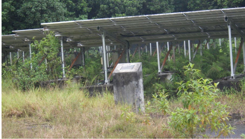
图 2.2-2 No.2 太陽光発電設備
