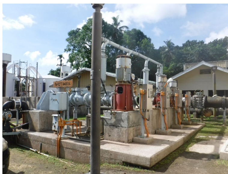
図 2.1-1 アイライ浄水場
