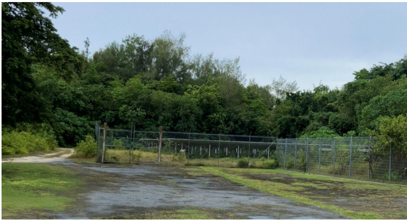
图 2.2-3 No.3 太陽光発電設備
