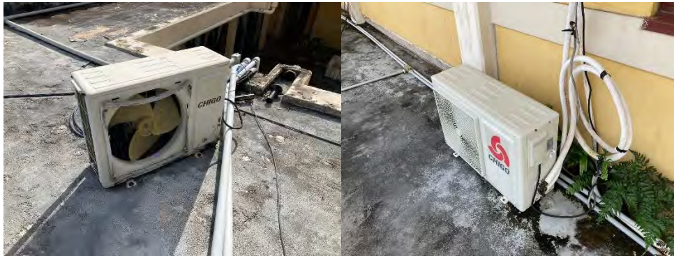
図 2-6 : コロール州庁舎にて現在使用されている空調
