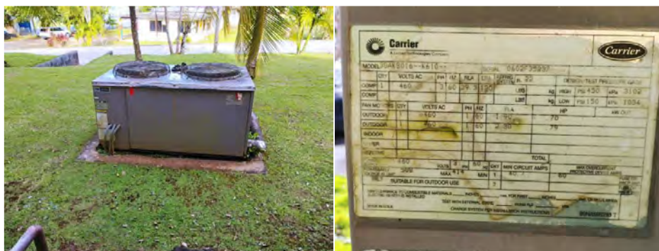
図 2-5：コロール州庁舎にある未稼働の空冷式空調
